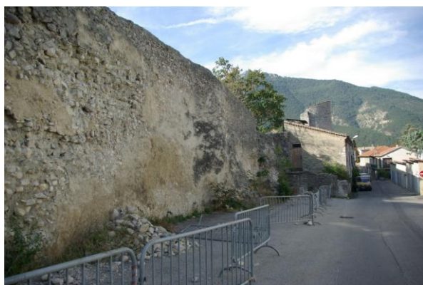
Vue rapprochée du parking de la Citadelle : les effondrements sont bien visibles
